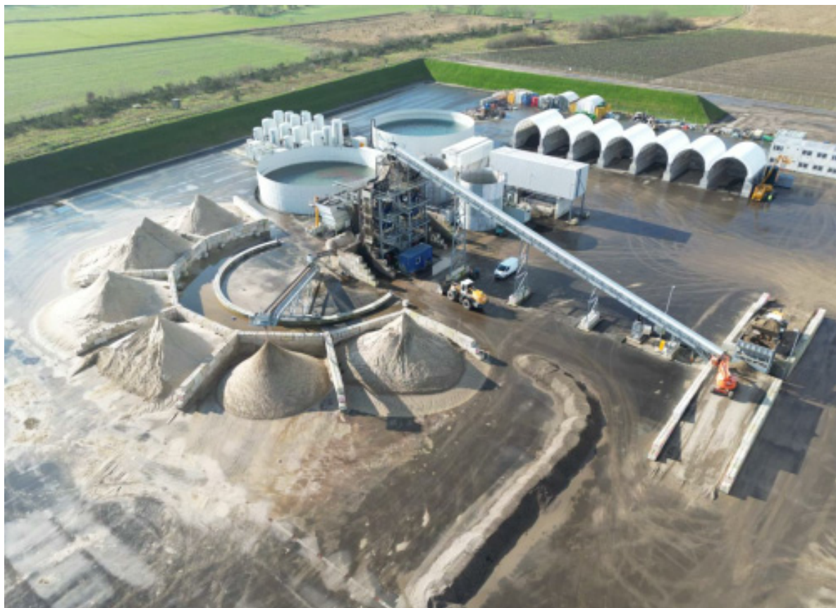
Abbildung: Bodenwaschanlage – Gesamtansicht im südlichen Teil des Material- und Bodenmanagements
