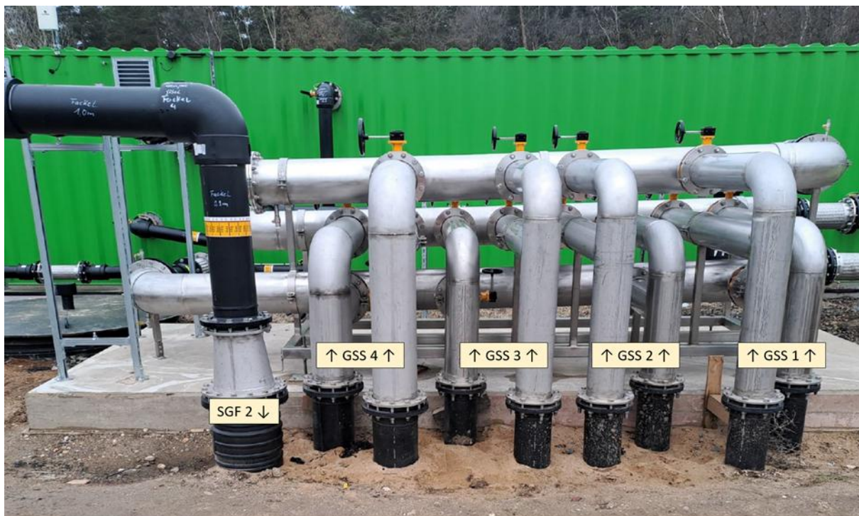
Abbildung 4: Gasverteilerbalken mit Anschlussmöglichkeiten der Gassammelstationen (GSS) 1 bis 4 an die Belüftung (oberer Balken), an die Schwachgasabsaugung (mittlerer Balken) oder auch bei entsprechender Qualität noch an die Gutgasabsaugung (unterer Balken), daneben der Abgang zur Schwachgasfackelstation (SGF), die neue Gasförderstation 1 steht im Hintergrund
