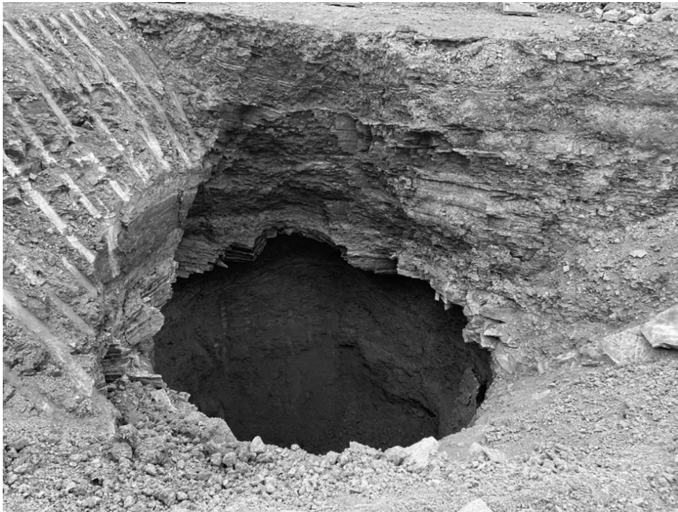
Abbildung 22: Erdfall Nr. 6 (exemplarisch), (Quelle: Franz Kassecker GmbH, 2024)
