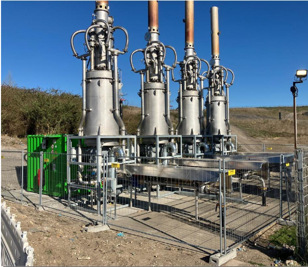
Abbildung 6: Fackelplateau mit vier Schwachgasfackeln
