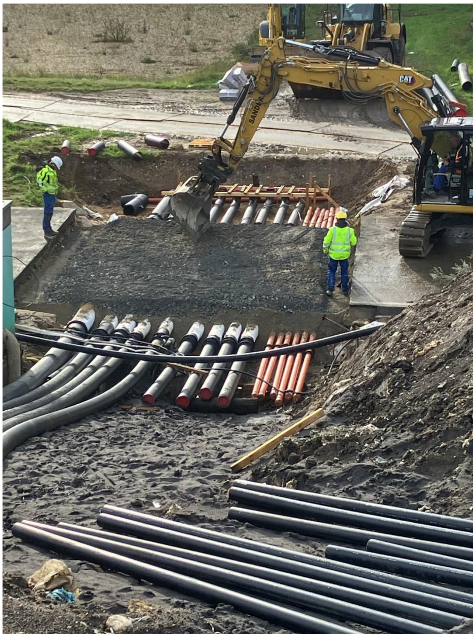
Abbildung 7: Zusammenführung der Transportleitungen vom dem Gasverteilerbalken mit Querung der Deponiezufahrt.
