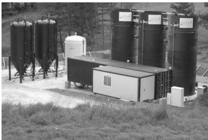
Abbildung 1: Mobile Bioreaktoranlage mit Ultrafiltrationscontainer und nachgeschalteter Aktivkohlestufe
