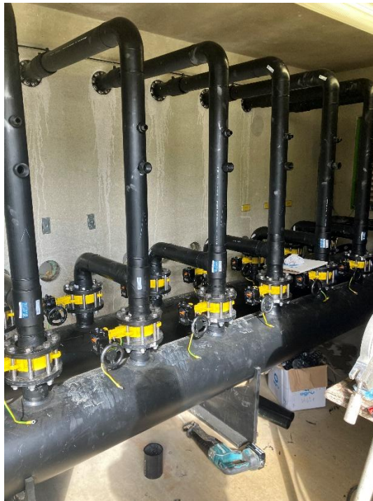
Abbildung 5: Umrüstung einer Gassammelstation mit alternativer Anschlussmöglichkeit der Gasleitungen auf zwei Gassammelbalken
